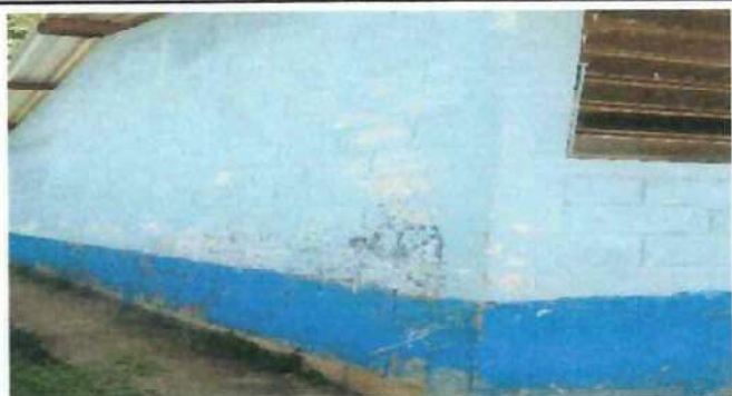
Foto 3: PINTURA EN MUROS EXTERIORES, POR EL DESGASTE DE LA PINTURA
