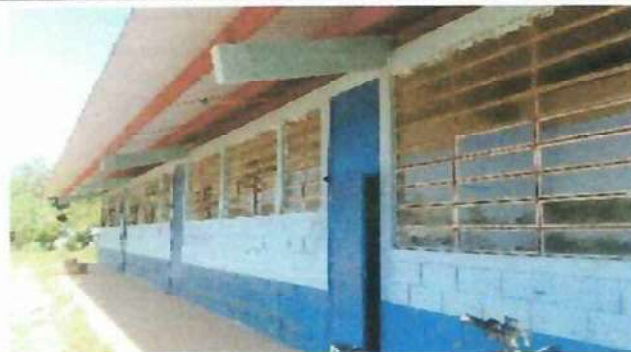
Foto 4: PINTURA EN MUROS EXTERIORES, PORQUE YA CADUCO EL TIEMPO DE DURABILIDAD DE LA PINTURA
