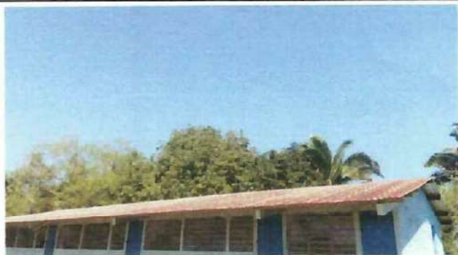
Foto 1: CUBIERTA DE LAMINA, POR EL DETERIORO DE SI MISMA
