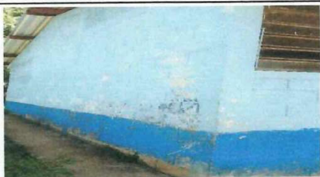
Foto 1: PINTURA EN MUROS EXTERIORES, POR SU DETERIORO DE LA PINTURA
