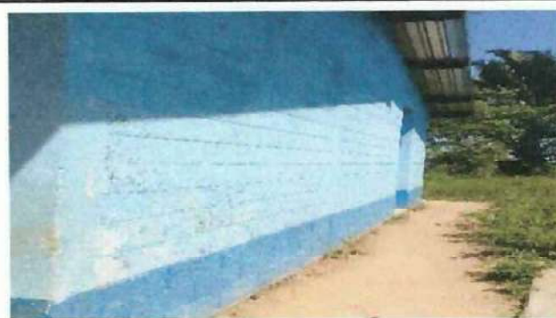
Foto 2: PINTURA EN MUROS EXTERIORES, ES NECESARIO LA APLICACION DE LA PINTURA POR EL MOHO O EL HONGO EN LAS PAREDES
