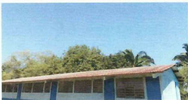
Foto 3: CUBIERTA DE LAMINA, ES NECESARIO LA INTERVENCION DE LA CUBIERTA DE LAMINAS POR SU DETERIORO
