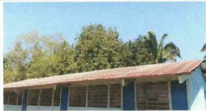
Foto 2: CUBIERTA DE LAMINA, SE OBSERVA EL OXIDO E ORIN DE LAS LAMINAS
